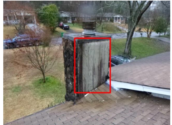
Chimney: wood rot
